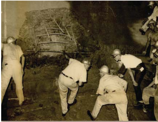
永久封堵段鍵槽混凝土爆破後，莫克公司顧問指導石建會工程人員檢查情形
