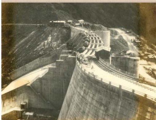
51年11月溢洪道橋之預力樑吊裝完成照 溢洪道上游側原為鏤空欄杆，葛樂禮颱風 後，經檢討改為混凝土翼牆
