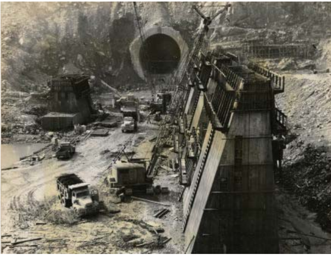
49年9月導水隧道出口導槽之導牆施工情形；出口導槽配合下游擋水壩，於導槽右側形成不受水流影響區域，以進行電廠施工
