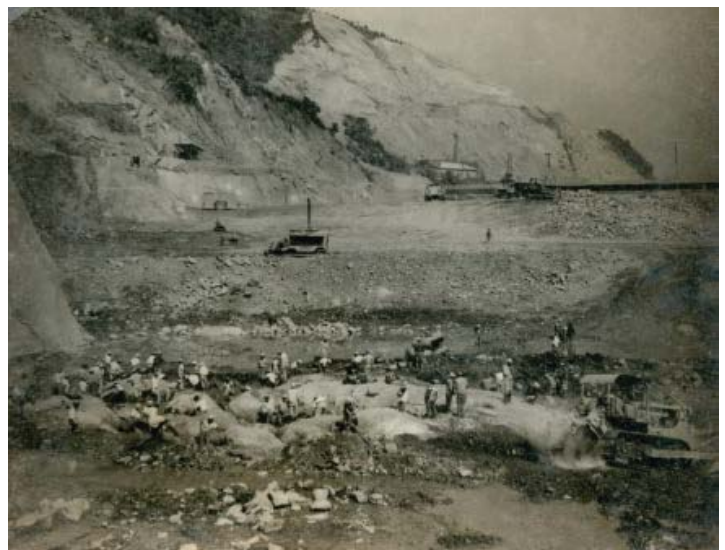
民國50年11月大壩心壕（Core Trench） 開挖情形。心壕為心層所在位置，須開 挖至堅硬岩盤，並進行隔幕灌漿。
