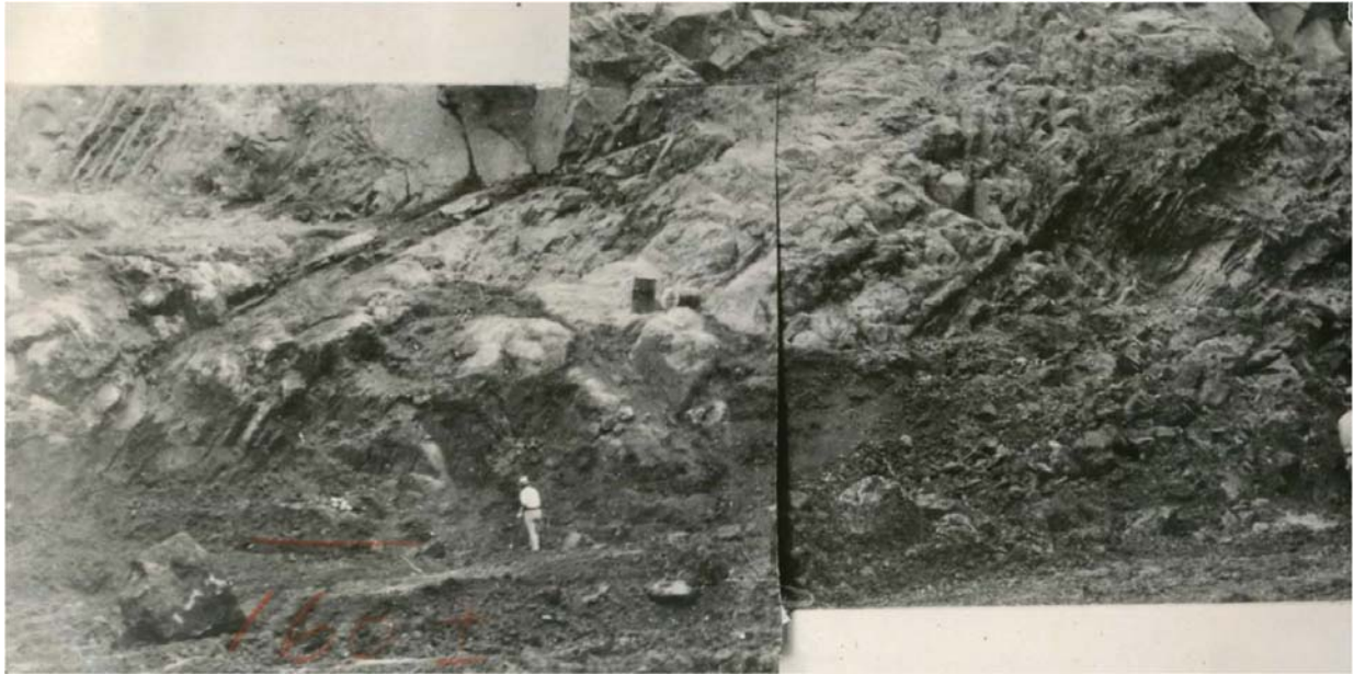
48年6月大壩基礎開挖後，大壩左山脊有明顯的裂縫
